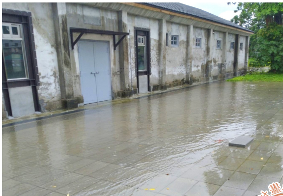
瞬間大雨時無法及時排水，致倒流回倉庫
