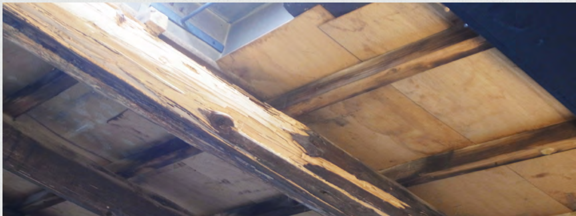
白蟻侵蝕樣貌
