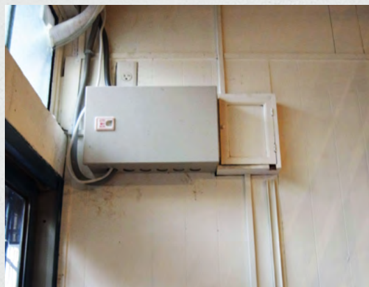
在換新電表線路後，建議與總開關一起換新。
