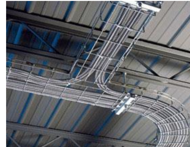
附圖 5-11 弱電系統共用纜線架
